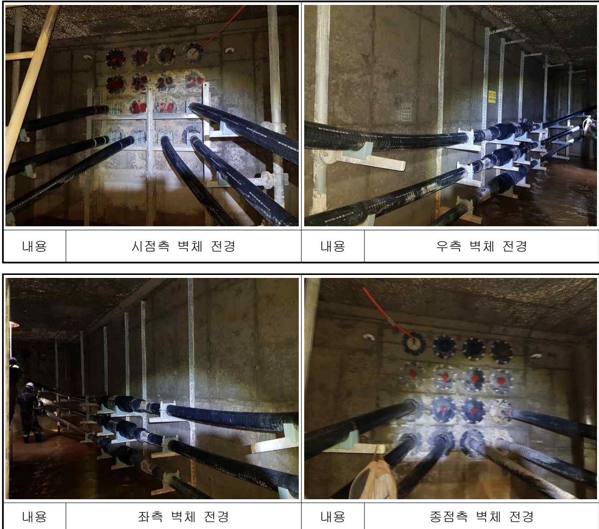
【사진 7.49】 신파주~송포 #13 전경
