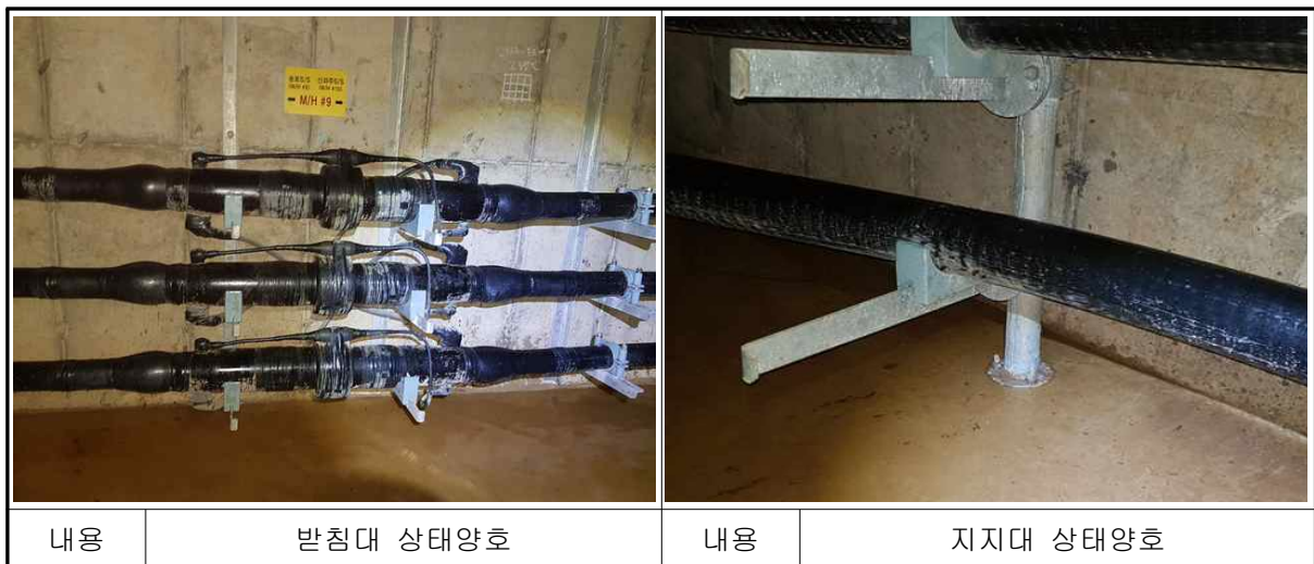
【사진 7.36】 부속 및 부대설비 현황
