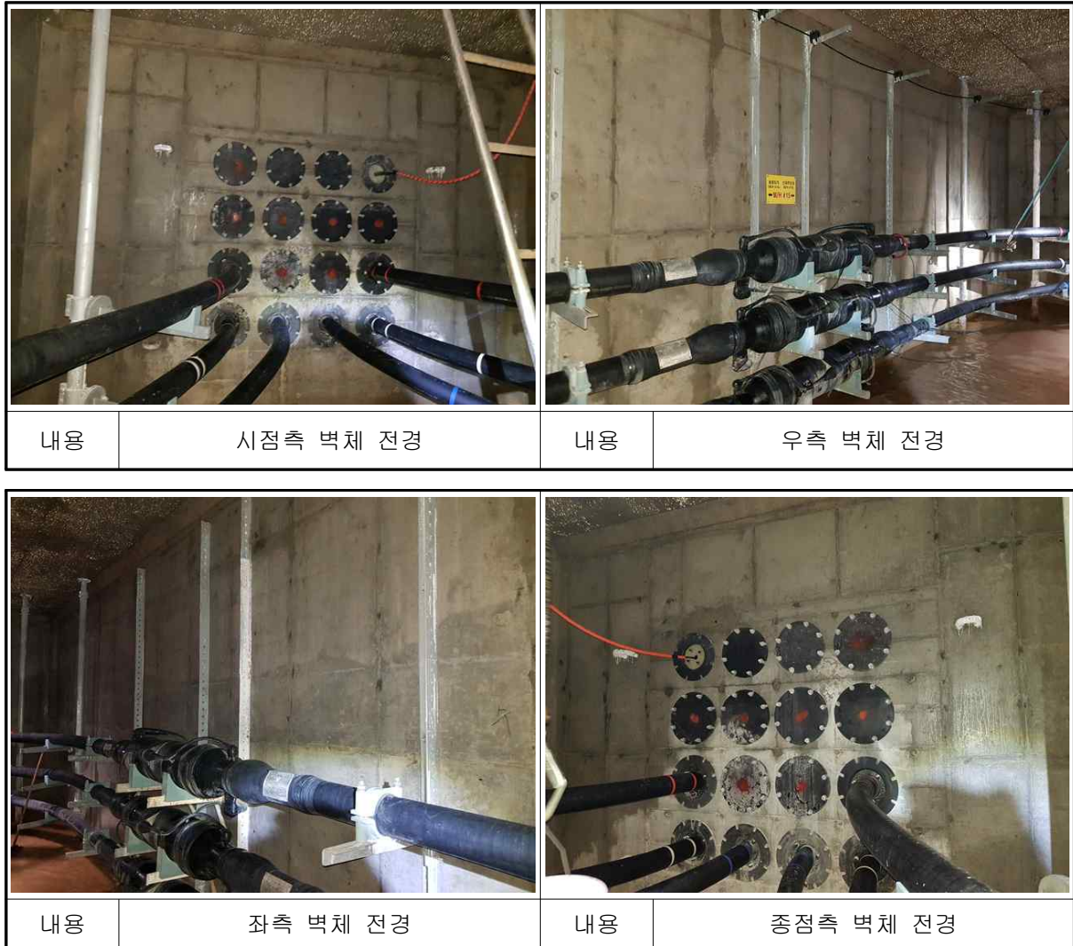
【사진 7.53】 신파주~송포 #15 전경
