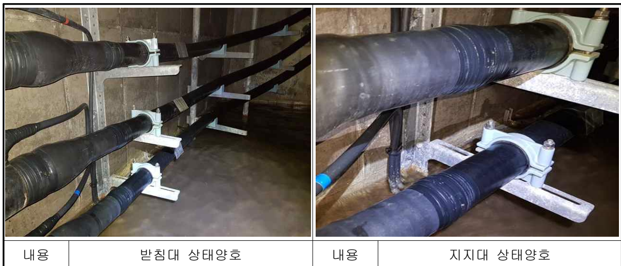
【사진 7.40】 부속 및 부대설비 현황
