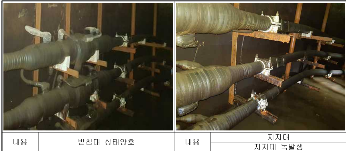
【사진 7.16】 부속 및 부대설비 현황
