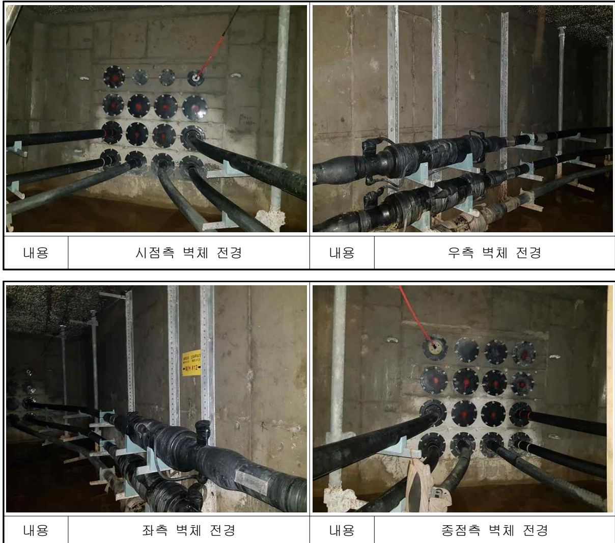
【사진 7.45】 신파주~송포 #12 전경
