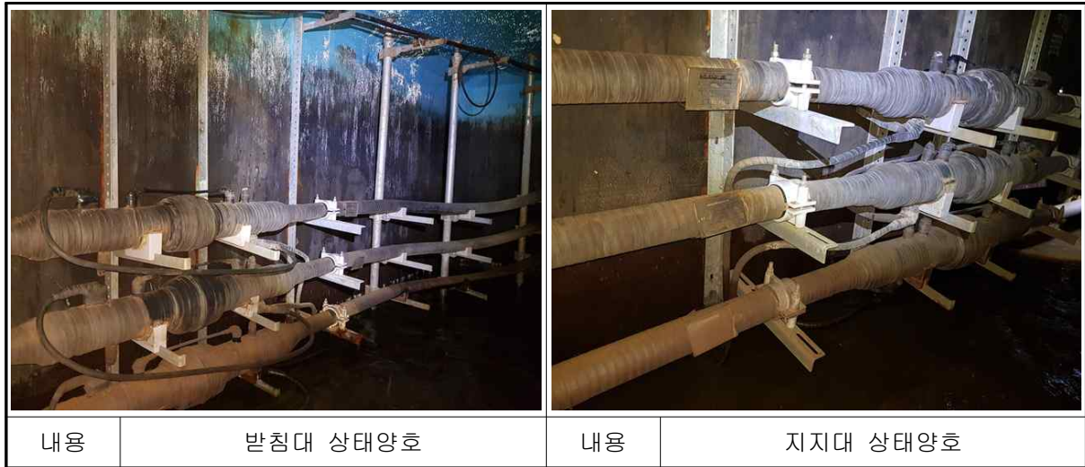
【사진 7.24】 부속 및 부대설비 현황
