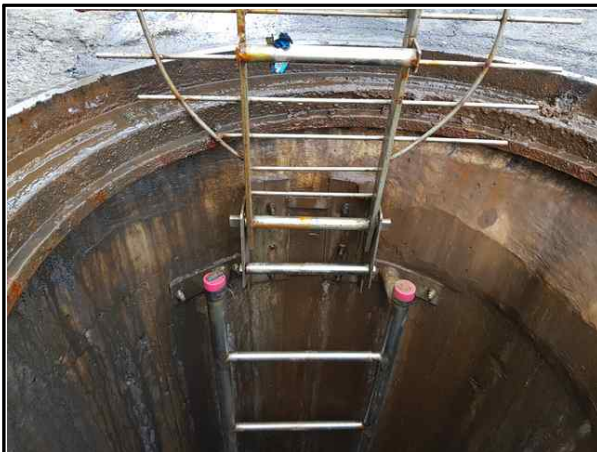
내용 추락방지시설 앵커볼트 파손
