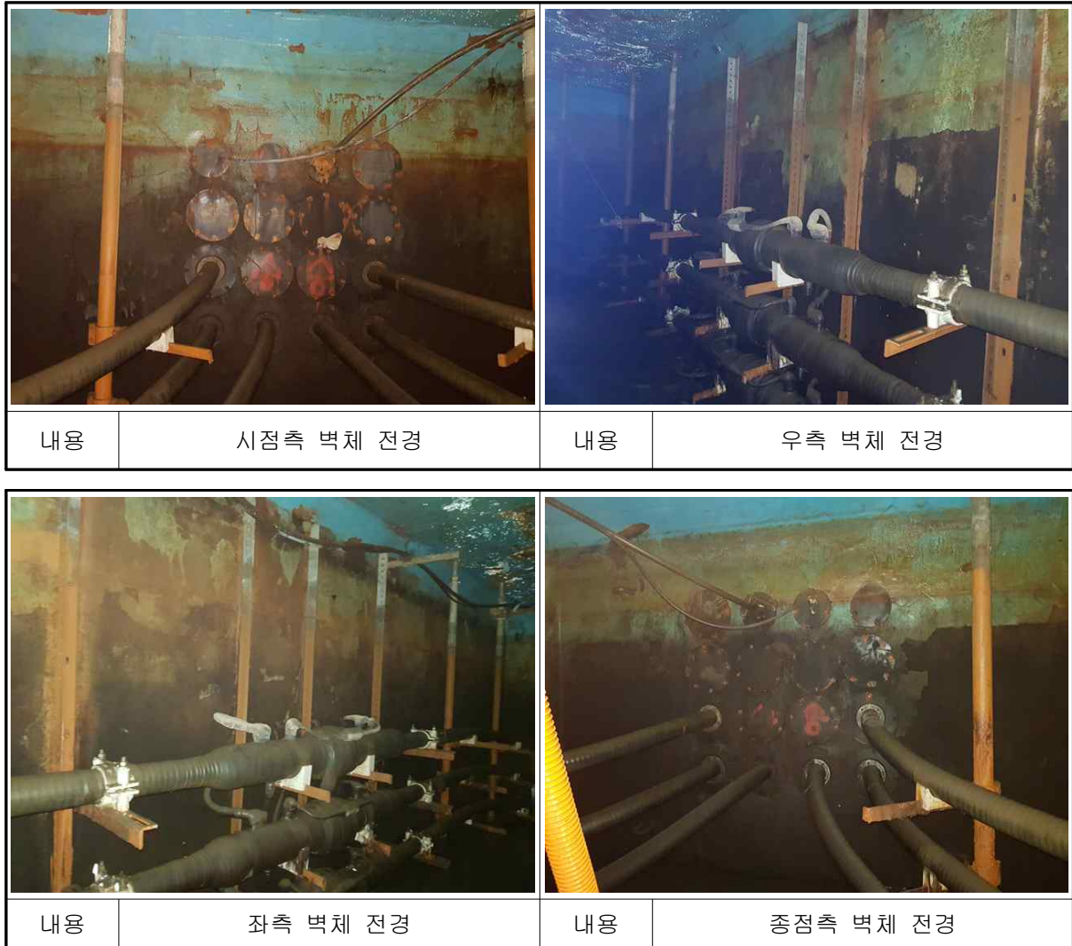
【사진 7.13】 신파주~송포 #4 전경
