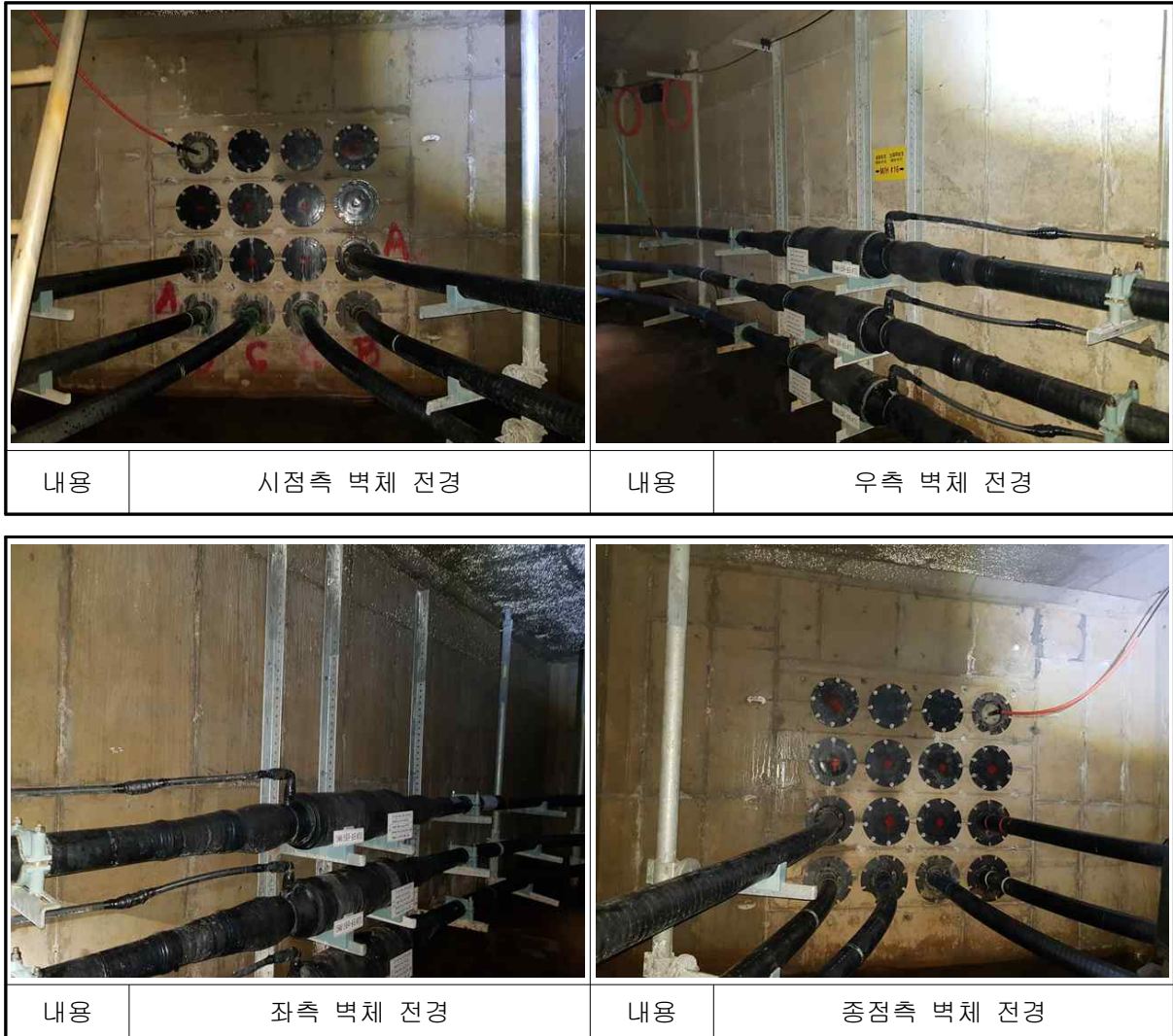
【사진 7.57】 신파주~송포 #16 전경
