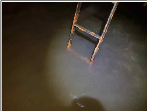
내용 추락방지시설 사다리 하부 고정불량
