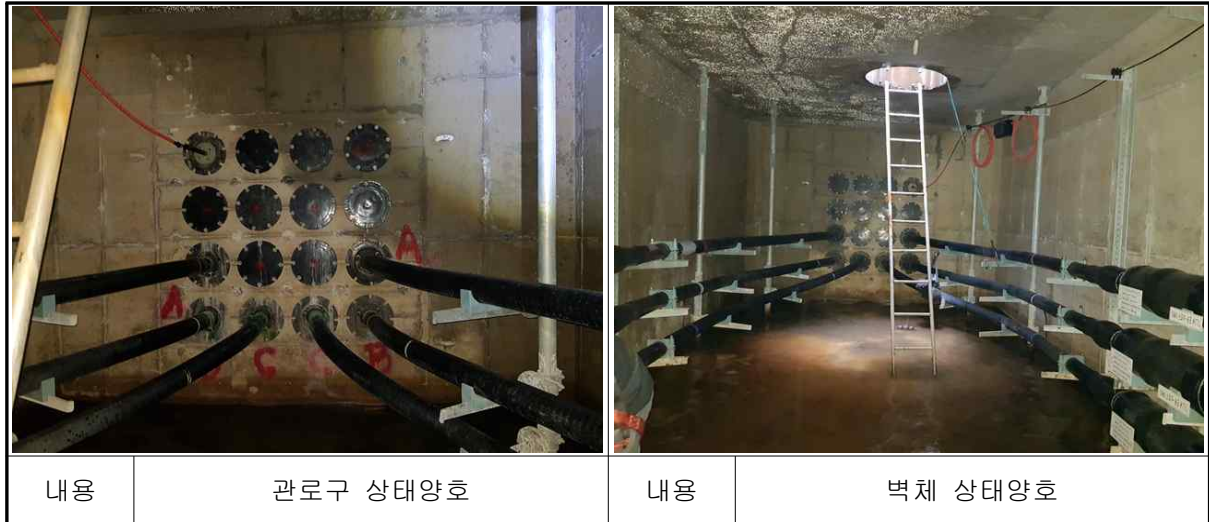
【사진 7.58】 맨홀 내부 주요 손상
