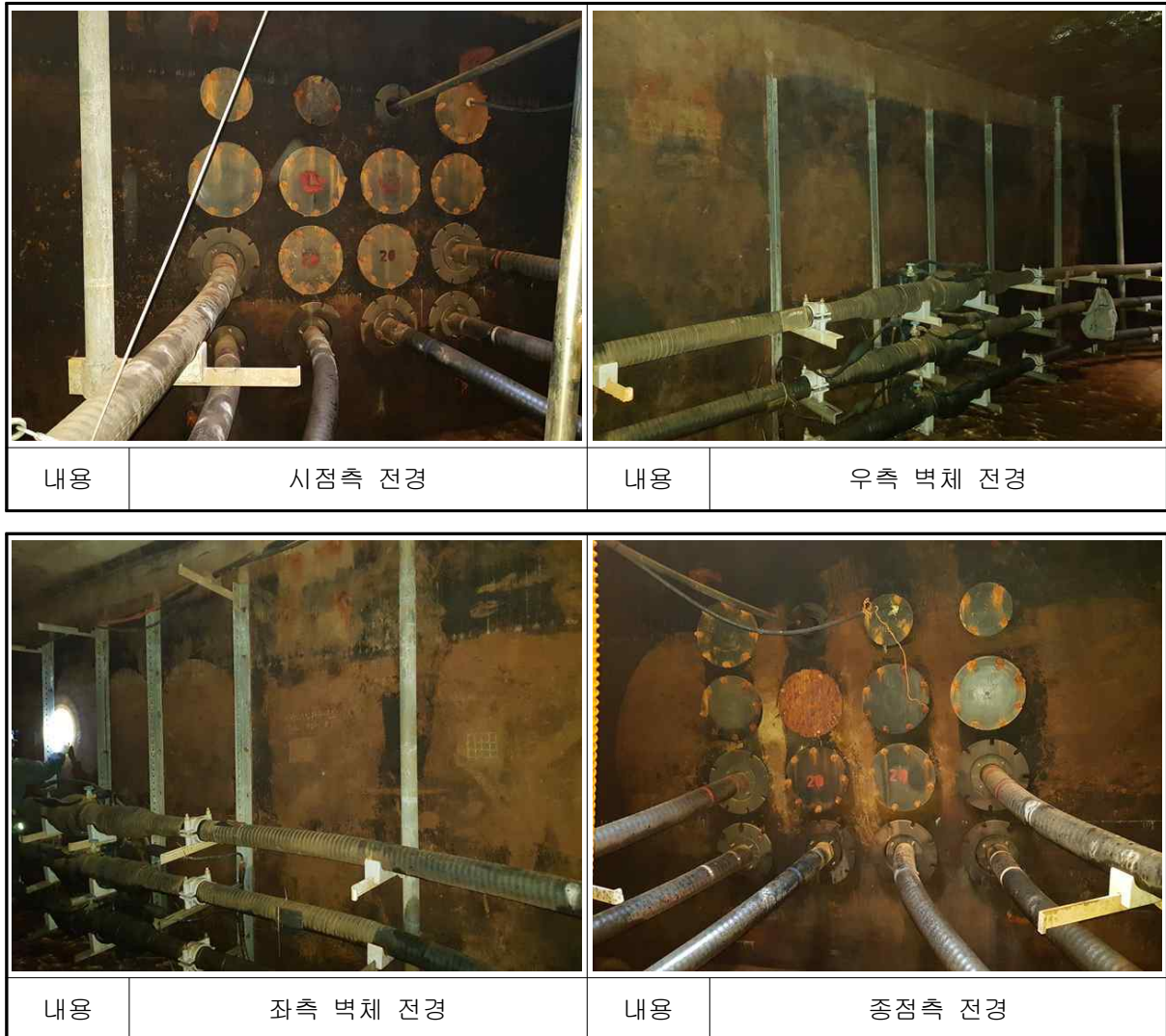
【사진 7.1】 신파주~송포 #1 전경
