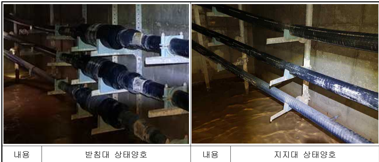
【사진 7.52】 부속 및 부대설비 현황
