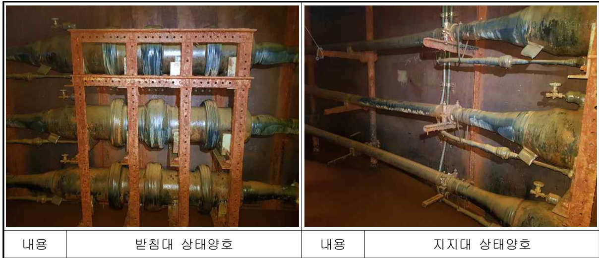
【사진 7.28】 부속 및 부대설비 현황
