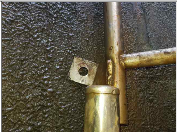
내용 추락방지시설 안전사다리 볼트탈락
