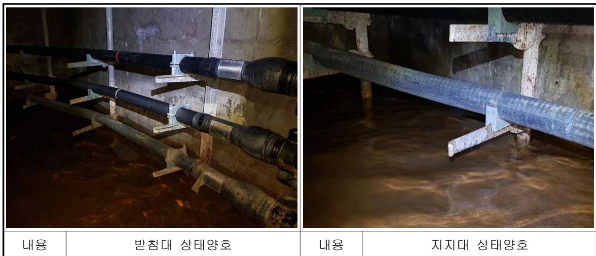
【사진 7.48】 부속 및 부대설비 현황
